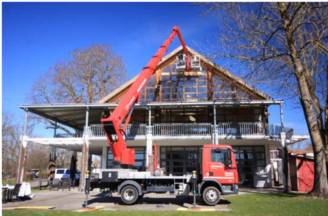
Auch in luftiger Höhe arbeitet der Betrieb von Malermeister Felsner. Die Holzelemente der Clubhaus-Fassade bekommen einen neuen Anstrich.
